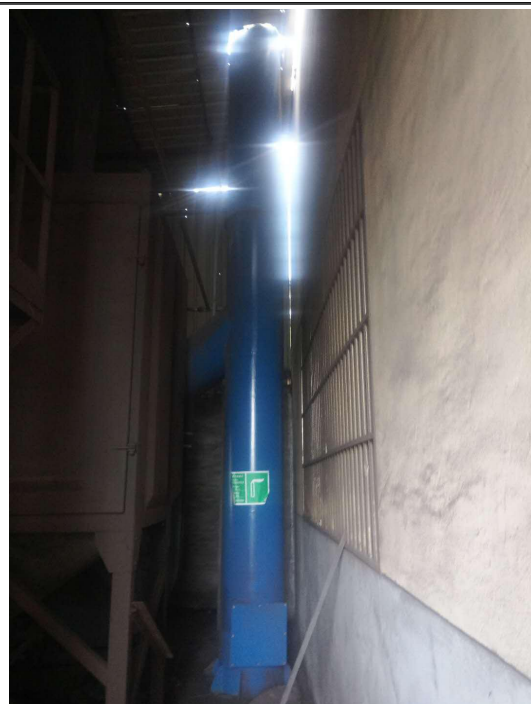
抛丸废气经滤筒除尘器+15米高排气筒排放
