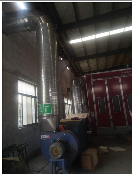
二级活性炭吸附装置处理喷漆废气
